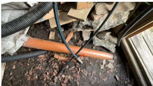
Del av rør til avløp.
