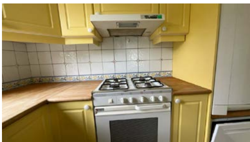
Montert avtrekk over komfyr.
