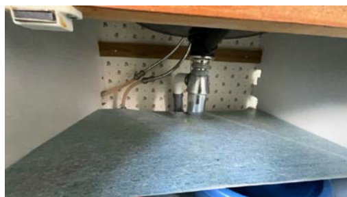
Del av rør til avløp.
