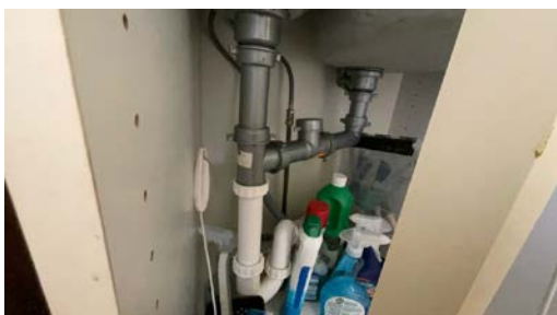
Del av rør til avløp.
