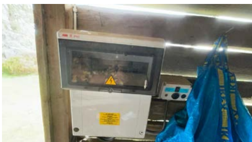
Styreskap til avløpspumpe.
