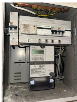
Sikringsskap med automatsikringer.
