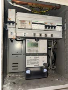
Sikringskap med automatsikringer.
