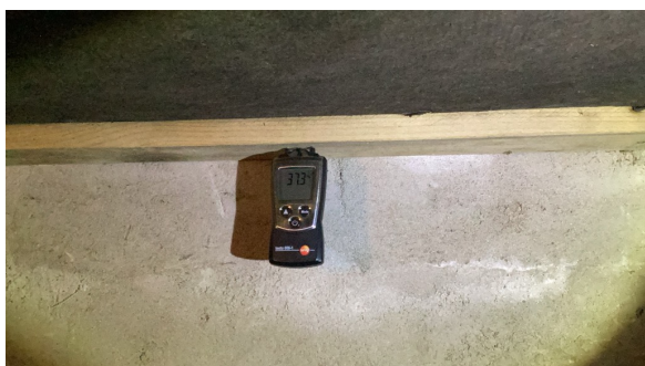
Fukttinnhold i treverk på over 30 vektprosent.
