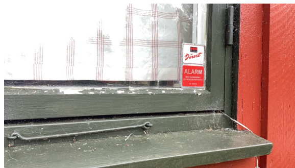
Eksempel på slitasje.
