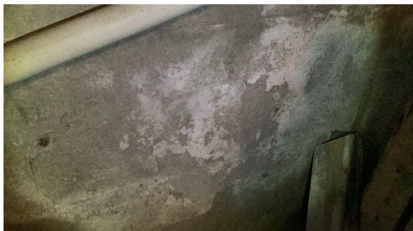
Eksempel på avskaling på vegg
