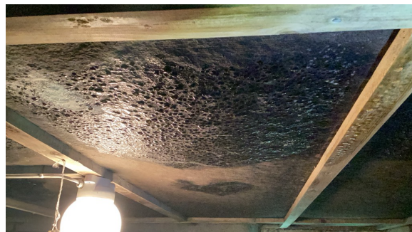
Det er kondens på overflater.
