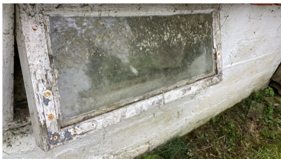
Eksempel på slitasje.
