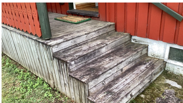
Eksempel på slitasje.
