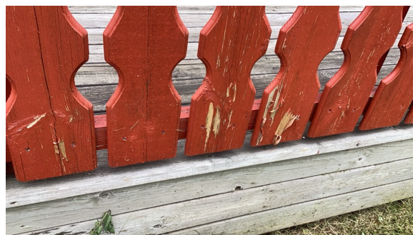
Eksempel på slitasje.
