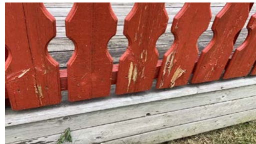
Eksempel på slitasje.
