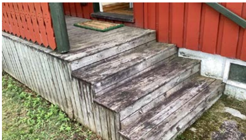
Eksempel på slitasje.
