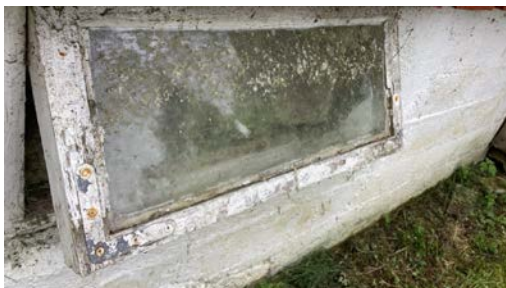
Eksempel på slitasje.
