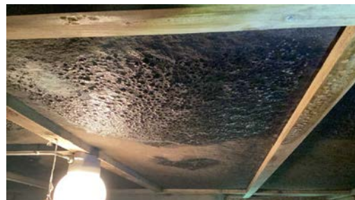
Det er kondens på overflater.
