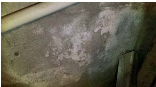
Eksempel på avskaling på vegg
