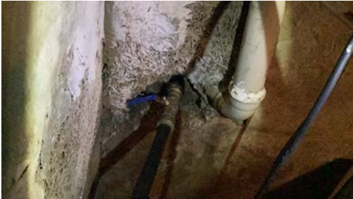
Vanninntak i kjeller.
