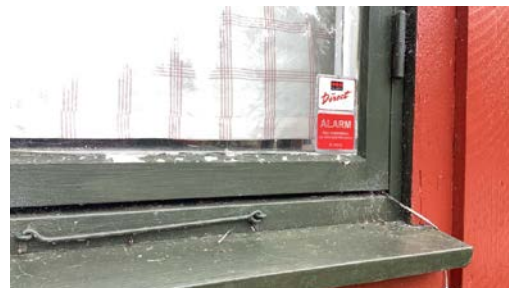
Eksempel på slitasje.
