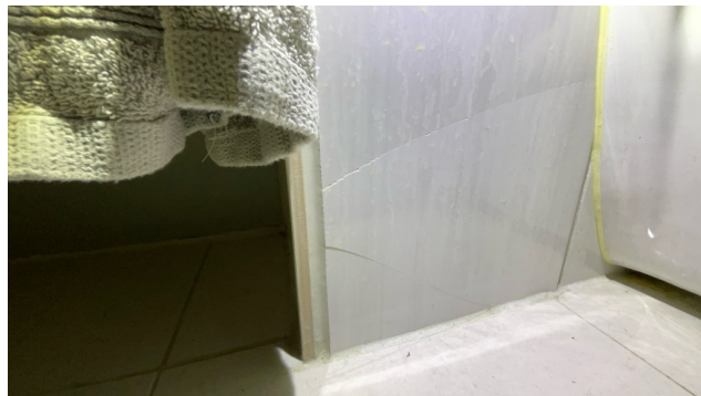
Sprukne fliser i nedre kant av toalettkasse.
