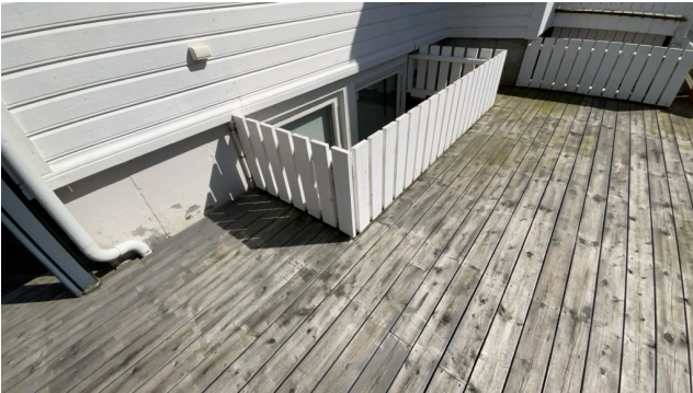
Rekkverk rundt lysgrav ved terrasse er for lavt.
