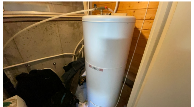
Varmtvannstank, eldre enn 20 år.
