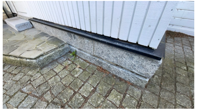
Liten avstand kledning/beslag ved inngangsparti.
