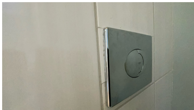
Sprukne fliser bak spyleknapp for toalett.
