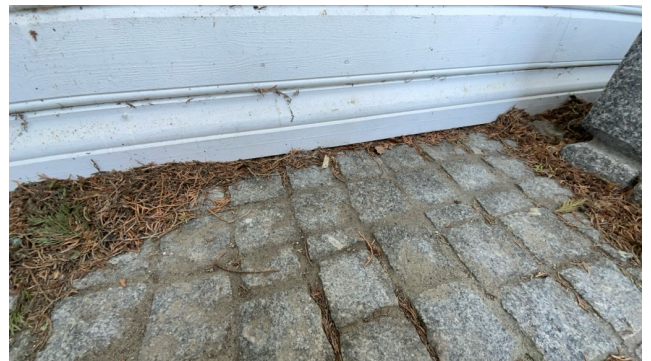
Liten avstand kledning/terreng.
