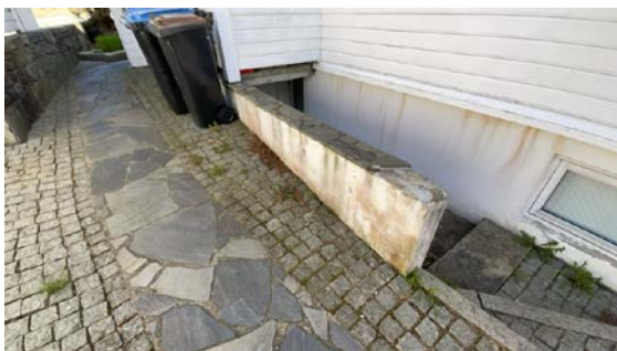
Mur rundt kjellertrapp er for lav iht. krav til sikring.
