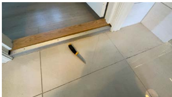
Det er registrert "bom"/manglende limdekning i/under enkelte fliser på gulv.
