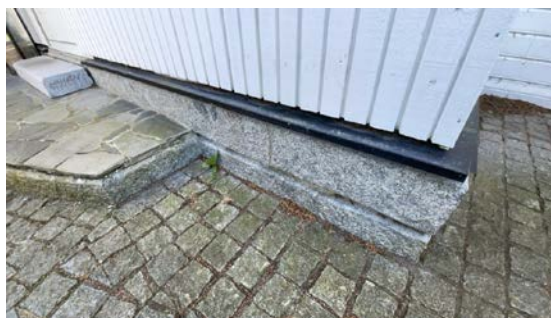
Liten avstand kledning/beslag ved inngangsparti.
