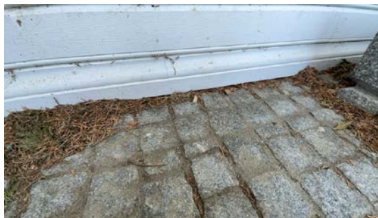
Liten avstand kledning/terreng.
