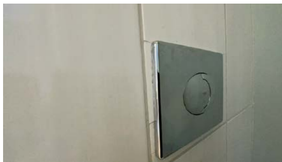
Sprukne fliser bak spyleknapp for toalett.
