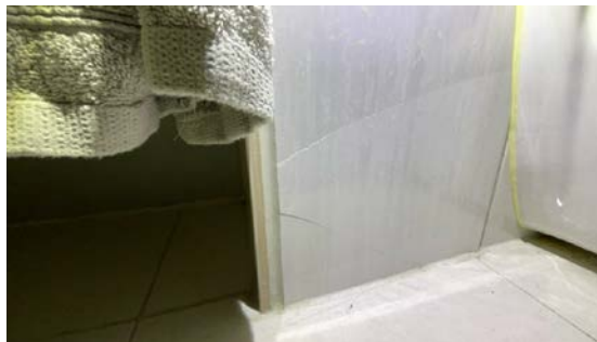
Sprukne fliser i nedre kant av toalettkasse.
