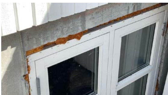
Det er ikke tilstrekkelig tettet utvendig rundt vindu til kjeller.
