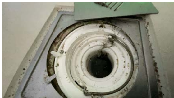
Sluk i gulv.
