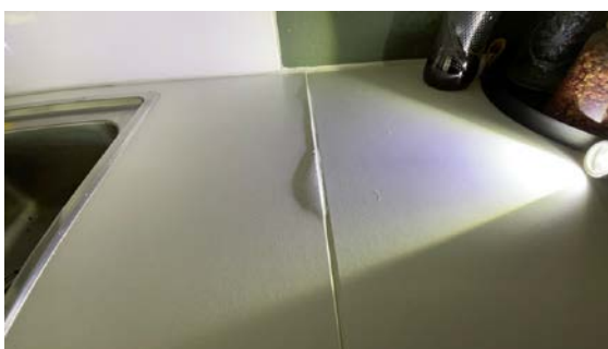
Fuktsvelling i skjøt av benkeplater.
