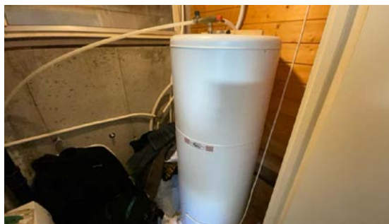
Varmtvannstank, eldre enn 20 år.
