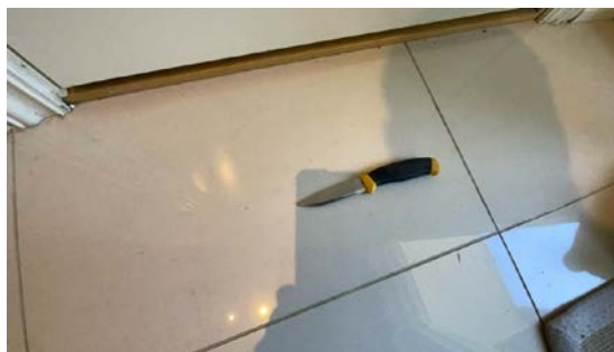
Det er registrert "bom"/manglende limdekning i/under flis på gulv ved inngangsdør og toalettrom i 1. etasje.
