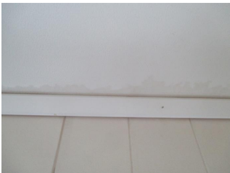
Fuktmerker ved kjøkken.
