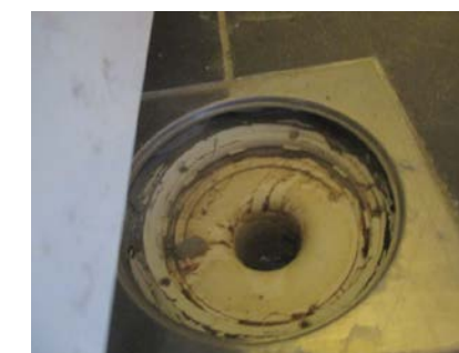
Sluk under dusjkabinett
