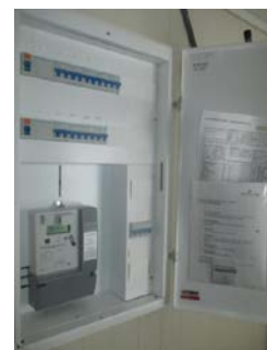
Sikringsskapet er plassert i bod/teknisk rom.
