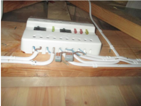
Regulator er plassert på loft ved luke i gangen.
