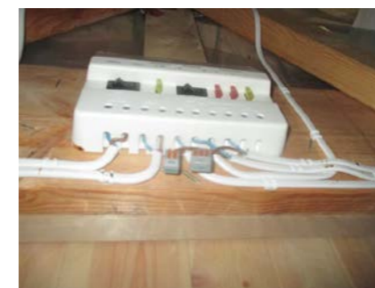
Regulator er plassert på loft ved luke i gangen.
