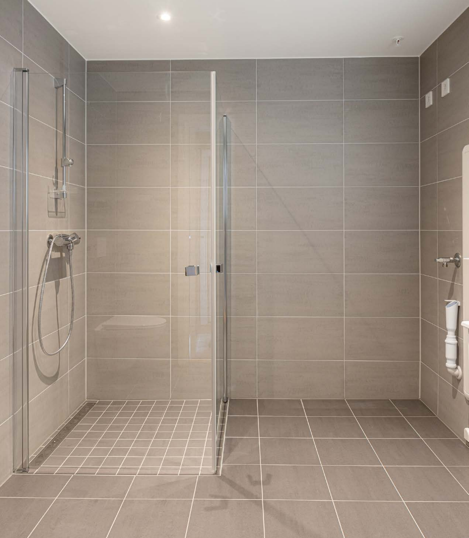
Dusjhjørne i aluminium og glass med hånddusj på stang. Det er opplegg for vaskemaskin
