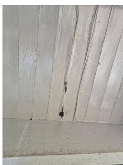
Råteskade i undergulv til balkong.
