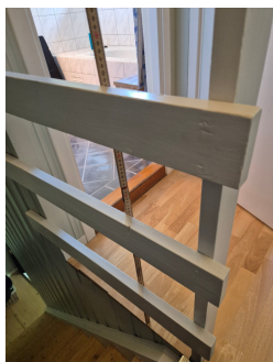
For lavt rekkverk og store åpninger.
