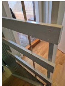
For lavt rekkverk og store åpninger.
