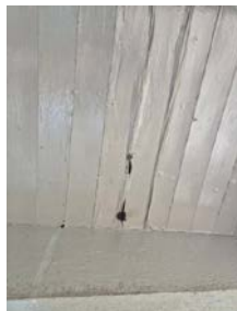
Råteskade i undergulv til balkong.
