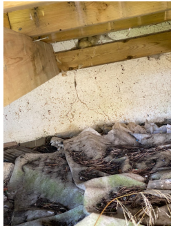
Sprekker i grunnmur observert under veranda.
