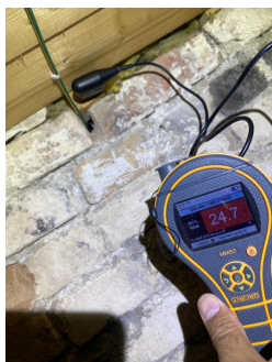
Påvist fukt i eksponert treverk i krypkjeller.
