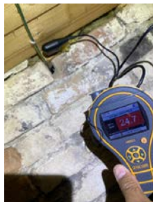
Påvist fukt i eksponert treverk i krypkjeller.
