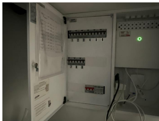
Sikringsskap plassert i bod.
