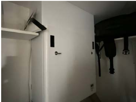
Ventilasjonsanlegg plassert i bod.
