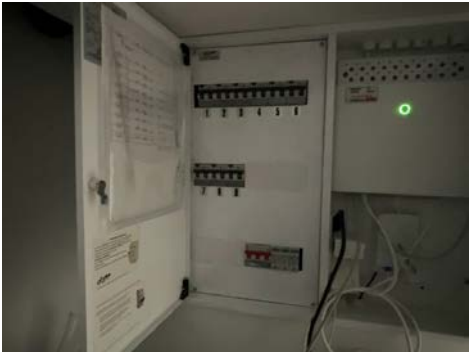
Sikringsskap plassert i bod.
