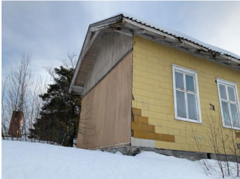
Dårlige veggplater og slitt kledning.
