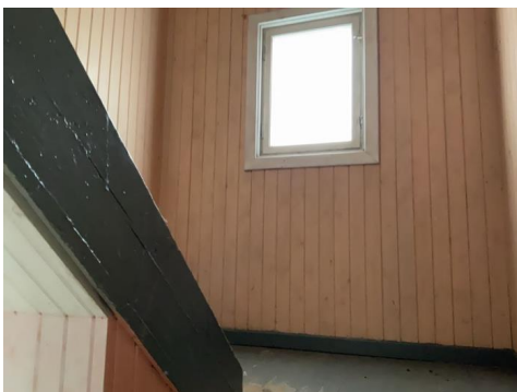
Trapp til loft uten rekkverk.
