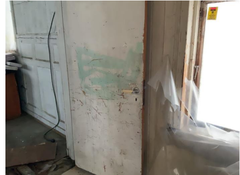
Skade på innvendige dører.
