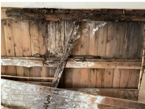
Påte i vegg i 2. etasje.
