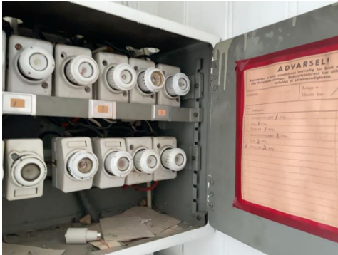
Sikringskapp med skrusikringer.
