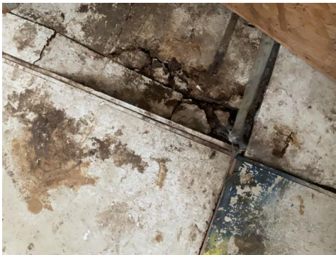
Råte i gulv i kjøkken.
