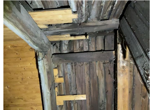
Råte i undertak.
