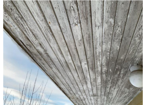
Råte i underkledning på veranda.
