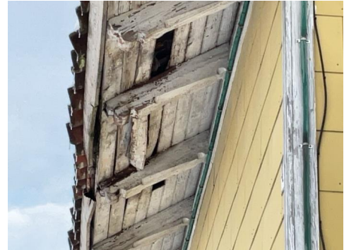
Råte i undertak/sperrer.
