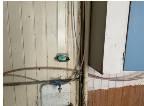
Røropplegg på kjøkken.
