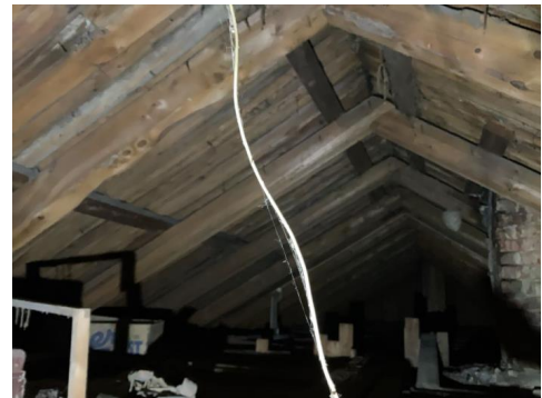
Påloft med fuktskader.
