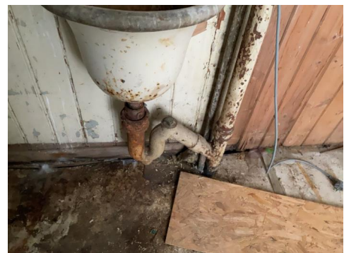
Røropplegg på kjøkken.
