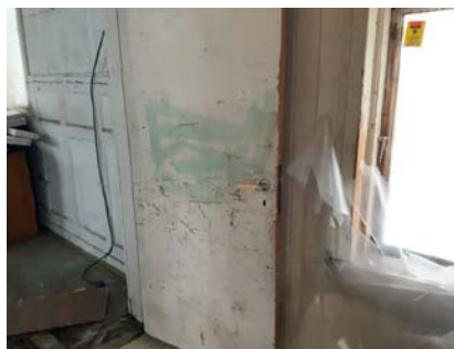
Skade på innvendige dører.
