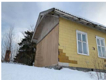
Dårlige veggplater og slitt kledning.
