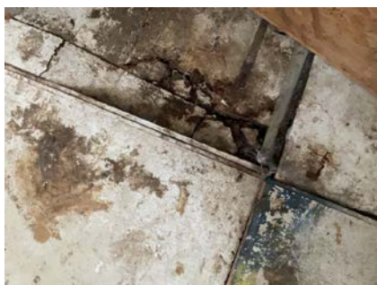
Råte i gulv i kjøkken.
