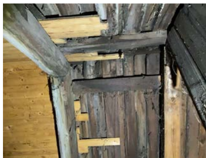
Råte i undertak.
