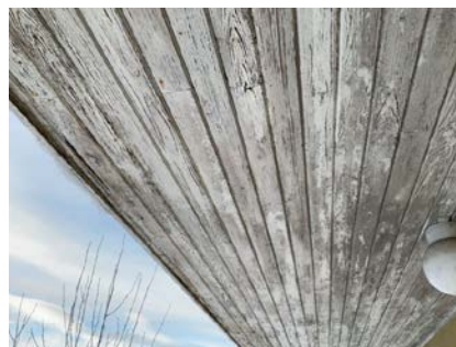
Råte i underkledning på veranda.
