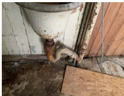
Røropplegg på kjøkken.
