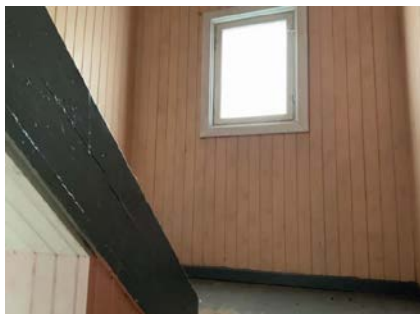
Trapp til loft uten rekkverk.
