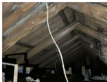
Påloft med fuktskader.
