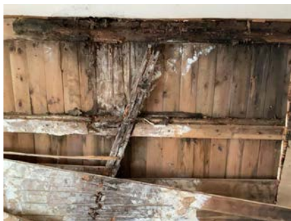
Påte i vegg i 2. etasje.
