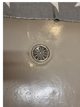
Sluk midt på gulv i vaskekjeller
