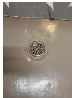
Sluk midt på gulv i vaskekjeller
