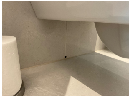
Lite hull i innkassing under klosett.
