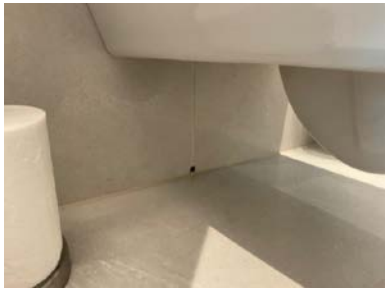
Lite hull i innkassing under klosett.
