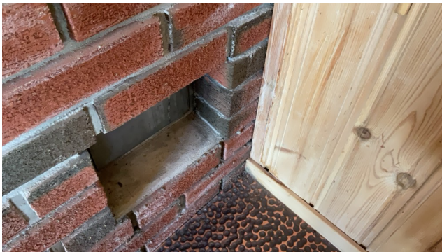
Brennbart materiale er plassert for nært sotluke
