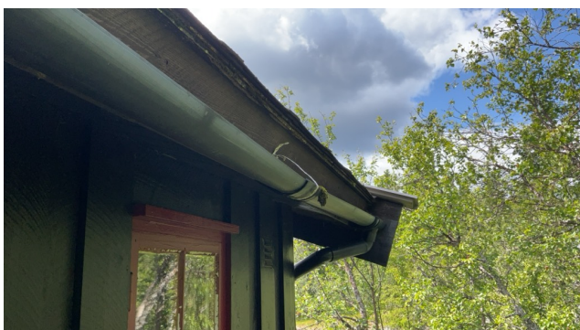
Enkel og ufagmessig løsning av takrenne og ikke tilstrekkelig innfesting, bør monteres ny med tilstrekkelig rennekroker og avstand på disse ihenhold til legganvisning
