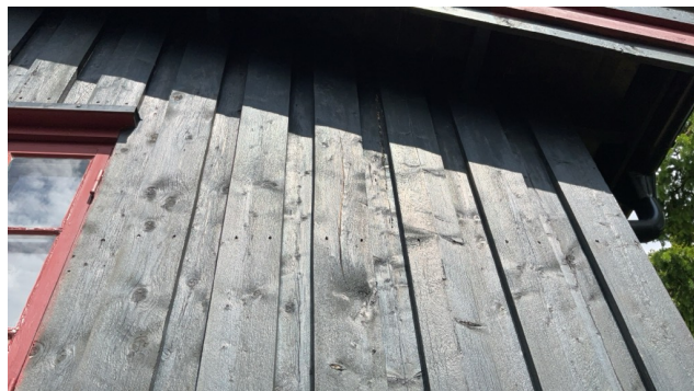
Oppsprukket enkelte kledningsbord
