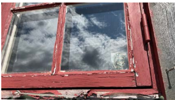
Vedlikeholdsetterslep og sprekker i kitt
