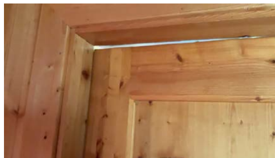
Skjevheter i hovedytterdør med glippe/luftlekkasje i overgang
