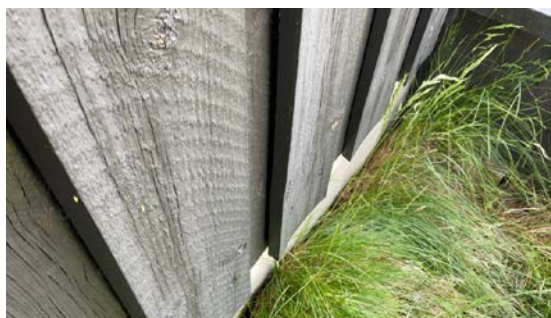
Kuving av kledningsbord på enkelte vegger, bør vurderes skifte av kledning da det er utettheter og mulige åpninger for mys/skadedyr
