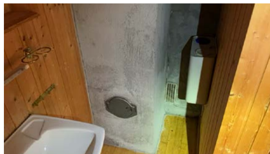
Avstand til brennbart materiale fra sotluke er for kort til vegg og gulv, sprekk i pipe fra vaskerom.
