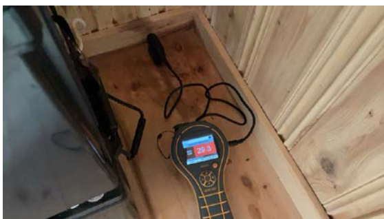
Fuktskjolder i hjørne på tilbygg, ved fuktmåletaking var det høyt fuktutslag der nærmere årsak og utbedring av følgeskader må foretas
