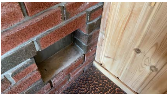
Brennbart materiale er plassert for nært sotluke
