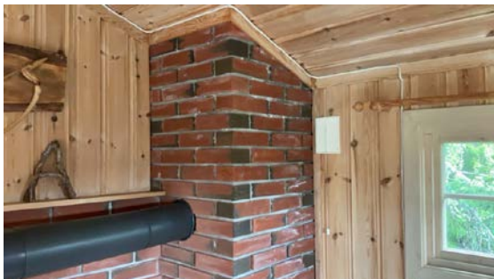
Saltutslag på pipe, overgang pipe og yttertak bør kontroll foretas eventuelle fuktinntregning kan forekomme som årsak
