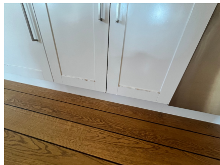
Fuktsvelling på fronter
