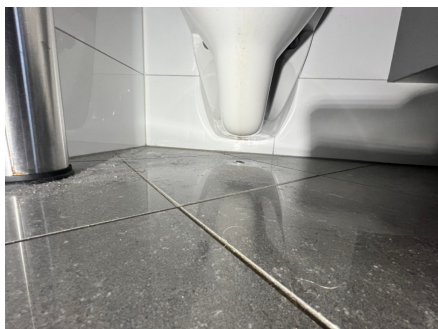
Ikke dreneringsåpning for innebygd vannsisterne.
