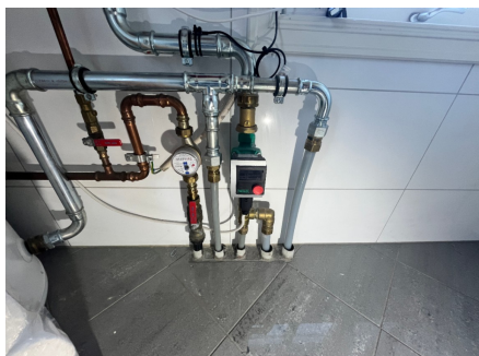
Stoppekran og vannmåler
