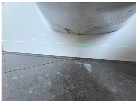
Drenering fra innebygd vannsisterne
