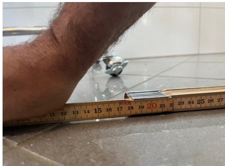
Ujevne overflater på gulv
