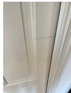
Skade på dørblad master bedroom
