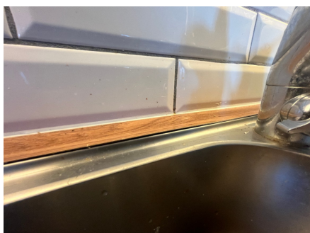
Fuktsvelling på benkeplate
