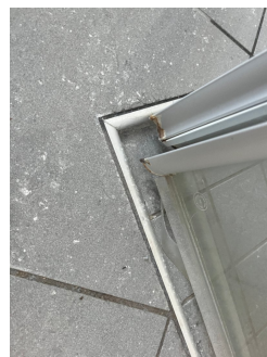
Løse plastlister og misfarget nedkant på dusjdører.
