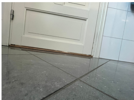
Ikke oppkant under dører
