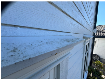
Ikke montert beslag på vannbrett og ikke laget luftespalte.
