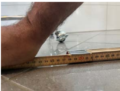
Ujevne overflater på gulv
