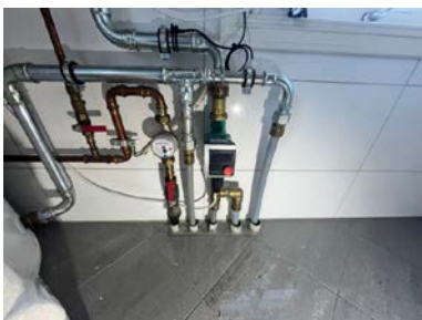
Stoppekran og vannmåler
