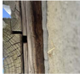
Lite lufting i bunn på vegg på tilbygget
