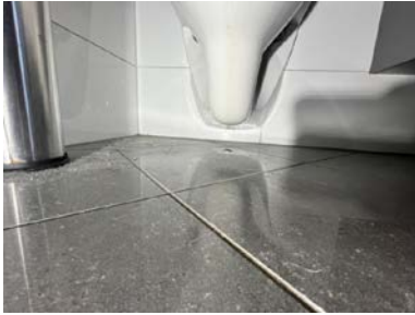
Ikke dreneringsåpning for innebygd vannsisterne.
