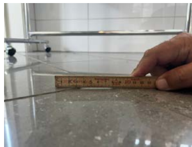
Ujevne overflater på gulv
