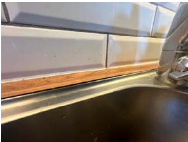
Fuktsvelling på benkeplate
