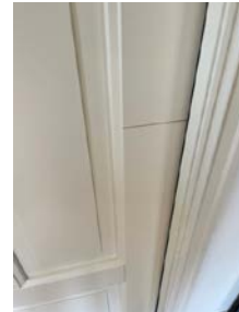
Skade på dørbled master bedroom
