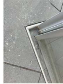
Løse plastlister og misfarget nedkant på dusjdører.
