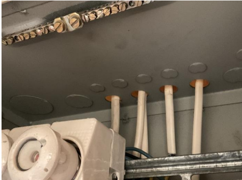
Hull i skap rundt kabelgjennomføringer.
