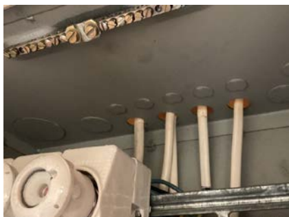
Hull i skap rundt kabelgjennomføringer.
