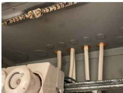
Hull i skap rundt kabelgjennomføringer.
