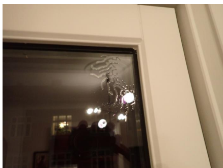
Delaminering av vindusglass
