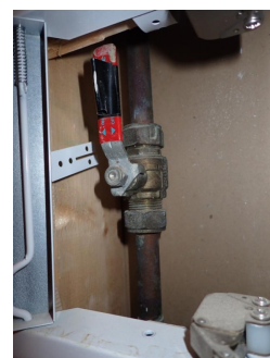
Stoppekran for kaldt vann i baderom
