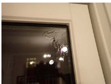
Delaminering av vindusglass
