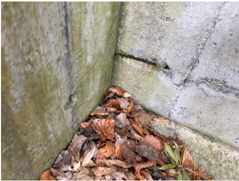
Støttemur kjeller vange
