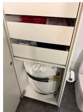
Bereder i bad/vaskerom sokkel leilighet
