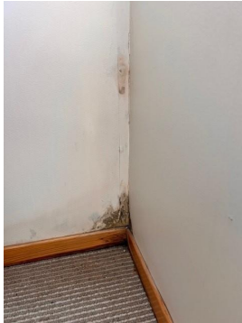
Fuktskader i vegger under innglassing.
