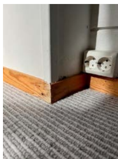
Fuktskader i vegger under innglassing.
