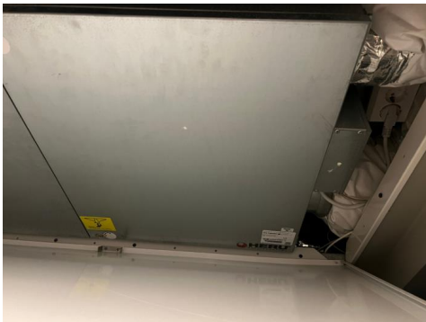
Balansert ventilasjonsaggregat i entrehimling
