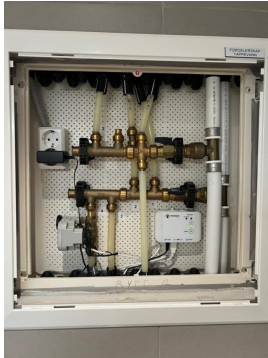
Rørskap på baderomsvegg med 2 x stoppekraner
