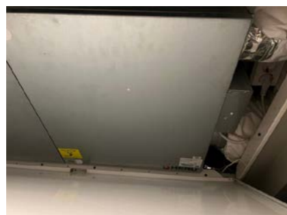
Balansert ventilasjonsaggregat i entrehimling
