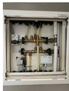
Rørskap på badersvegg med 2 x stoppekraner
