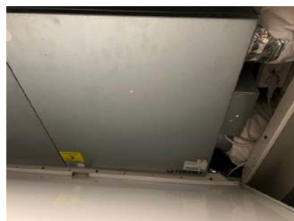
Balansert ventilasjonsaggregat i entrehimling
