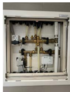
Rørskap på badervegg med 2 x stoppekraner
