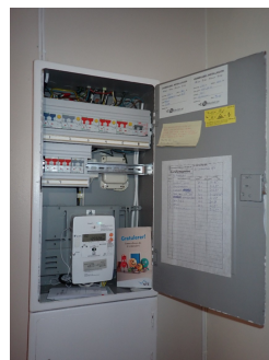
Sikringsskap med automatsikringer.
