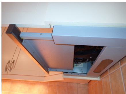
Filter i avtrekksvifte mangler.
