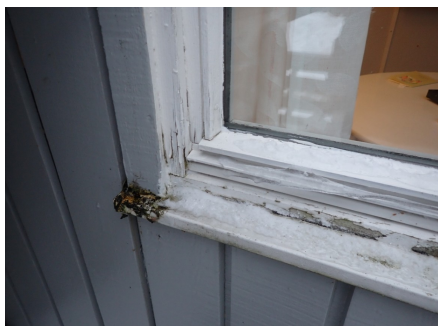
Høy slitasje i vindu / dekkbord.
