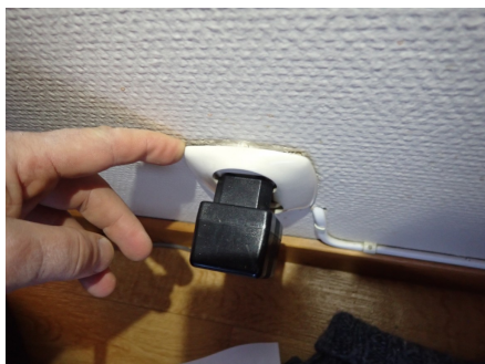
Løs stikkontakt på stue.
