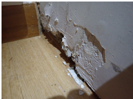
Skade i veggplate ved ytterdør.
