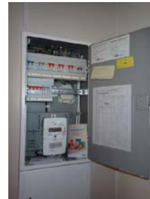
Sikringsskap med automatsikringer.
