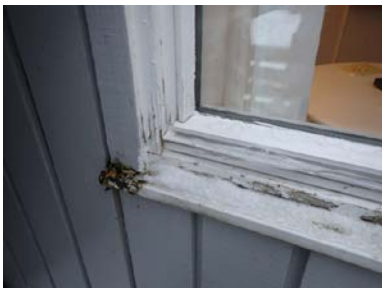
Høy slitasje i vindu / dekkbord.
