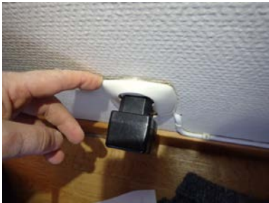
Løs stikkontakt på stue.
