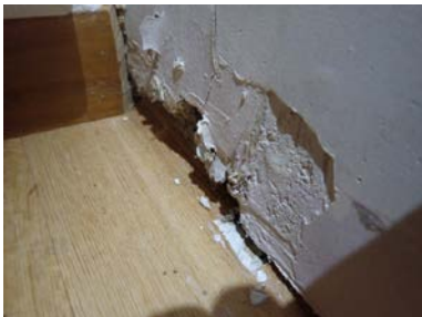
Skade i veggplate ved ytterdør.
