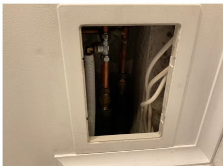
Rør-opplegg i tak i bad.
