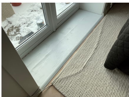
Gulv ved balkongdør.
