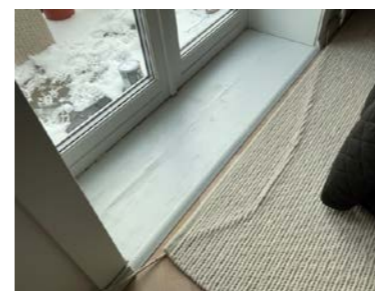
Gulv ved balkongdør.
