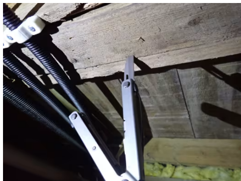
Påvist råde i treverk.
