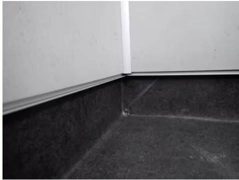
Mangler fuge i overgangen.
