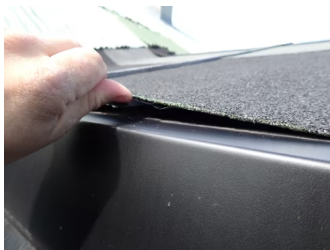
Utettheter ved takfot på tilbygg.
