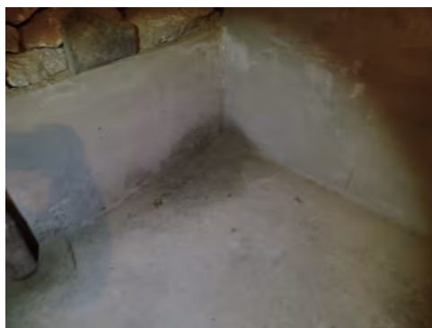
Fukt i mur/kjellergulv.
