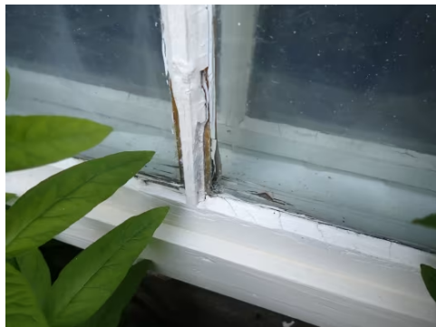
Slitasje i eldre vindu.
