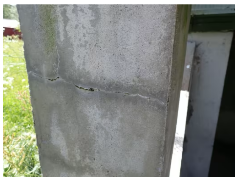
Sprekk i pilar.
