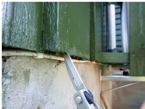
Tegn på noe råde i bunn av kledning.
