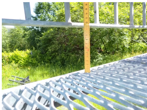
Åpninger i rekkverk, strekkmetalltrapp.
