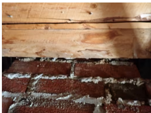
Skjolder i tak ved pipe.
