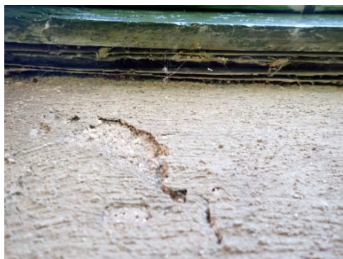
Begrenset lufting oppunder kledning.
