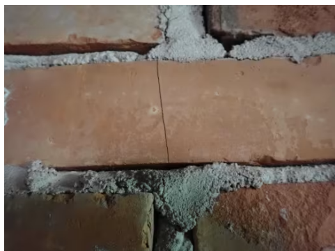
Sprekk i teglstein.
