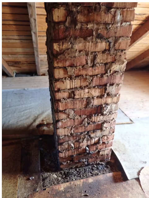
Beksot på pipemur.
