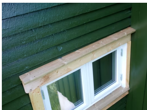
Manglende beslag over vindu / manglende overflatebehandling.
