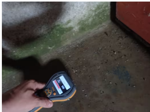
Fukt i mur/kjellergulv.
