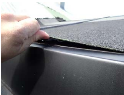
Utettheter ved takfot på tilbygg.
