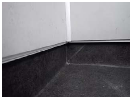
Mangler fuge i overgangen.
