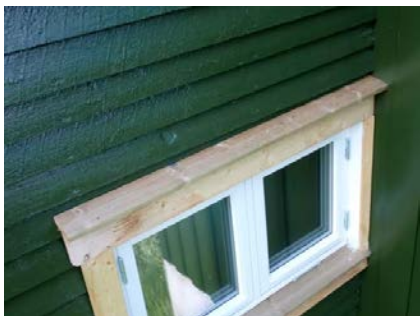
Manglende beslag over vindu / manglende overflatebehandling.
