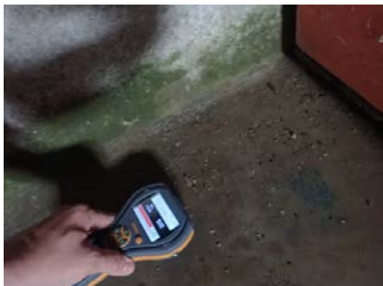
Fukt i mur/kjellergulv.
