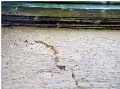
Begrenset lufting oppunder kledning.
