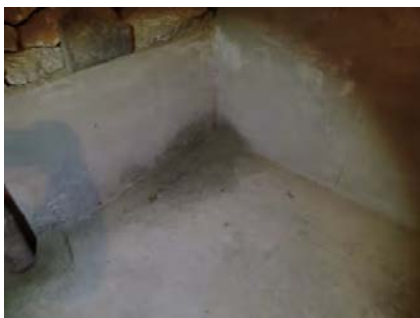
Fukt i mur/kjellergulv.
