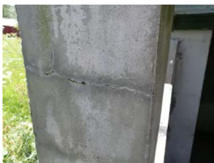
Sprekk i pilar.
