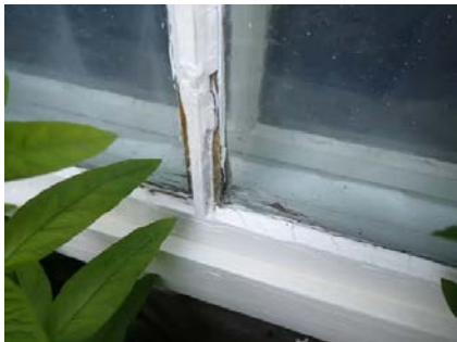
Slitasje i eldre vindu.
