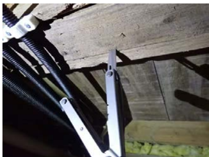
Påvist råte i treverk.
