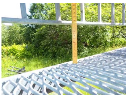
Åpninger i rekkverk, strekkmetalltrapp.
