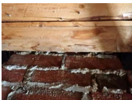
Skjolder i tak ved pipe.
