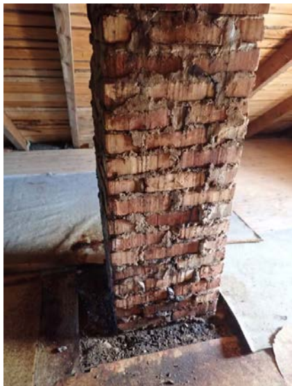
Beksot på pipemur.
