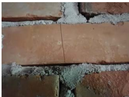
Sprekk i teglstein.
