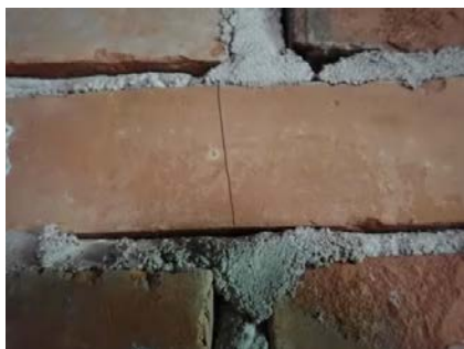
Sprekk i teglstein.
