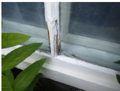
Slitasje i eldre vindu.
