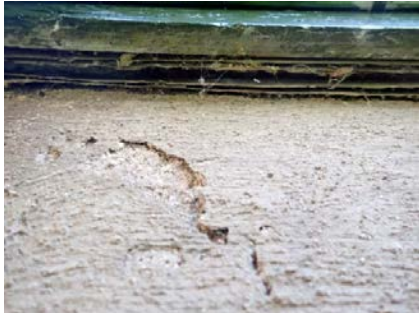
Begrenset lufting oppunder kledning.
