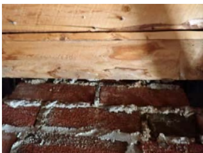
Skjolder i tak ved pipe.
