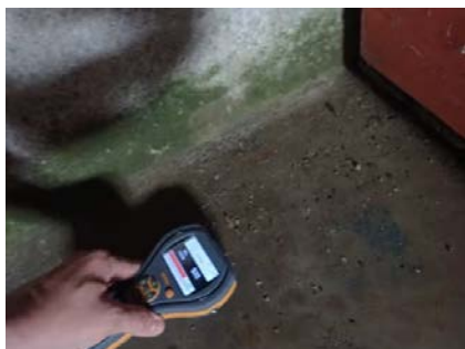
Fukt i mur/kjellergulv.
