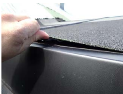
Utettheter ved takfot på tilbygg.
