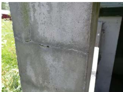
Sprekk i pilar.
