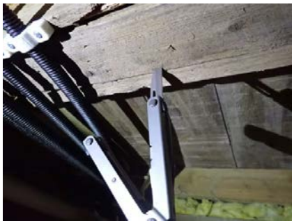
Påvist råte i treverk.
