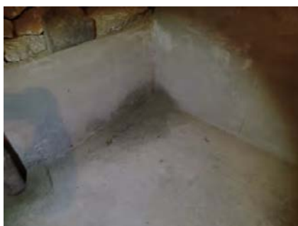
Fukt i mur/kjellergulv.
