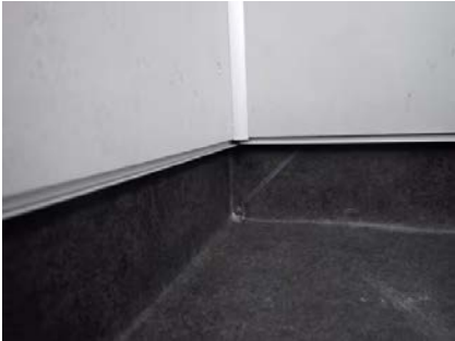
Mangler fuge i overgangen.
