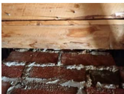
Skjolder i tak ved pipe.
