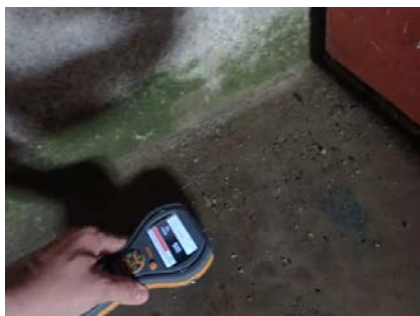
Fukt i mur/kjellergulv.
