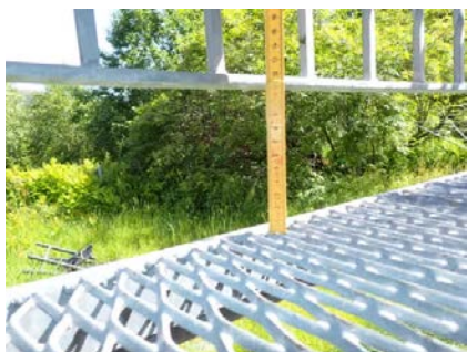
Åpninger i rekkverk, strekkmetalltrapp.
