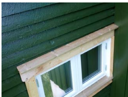
Manglende beslag over vindu / manglende overflatebehandling.
