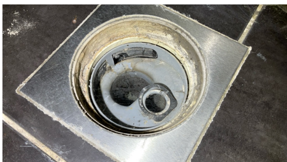
Sluk i gulv på vaskerom.
