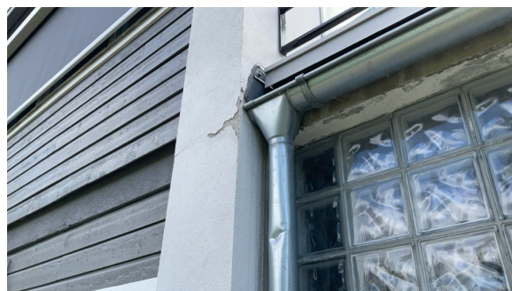
Skade på vegg etter lekkasje i takrenner.
