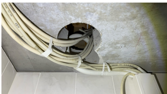
Hull i betongtak opp til hoveddel.
