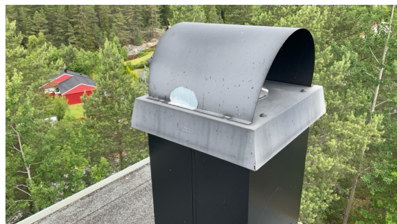
Noe overflatebehandling på pipebeslag mangler.
