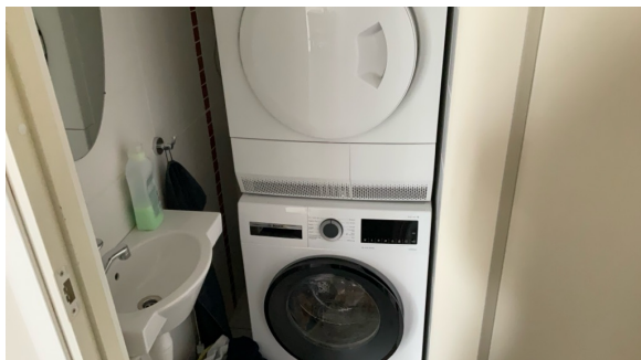
Vaskemaskin på toalettrom.
