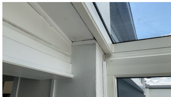
Noe lekkasje mot yttervegg når det regner nye ifølge eier.
