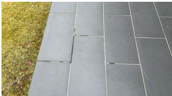
Løse fliser og manglende fugemasse.
