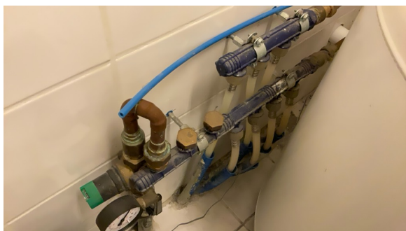
Vannrør kommer ut i rom med sluk.
