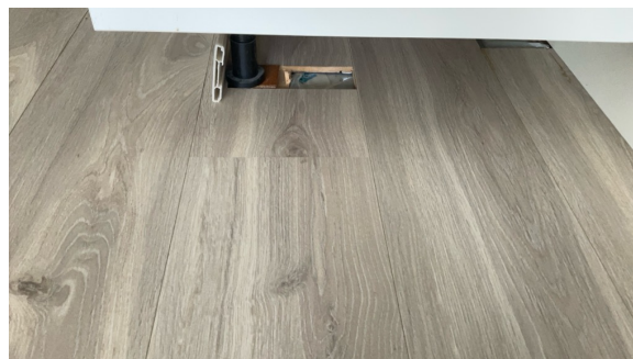
Noe manglende sokkel.
