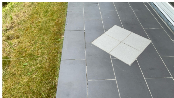
Løse fliser og manglende fugemasse.
