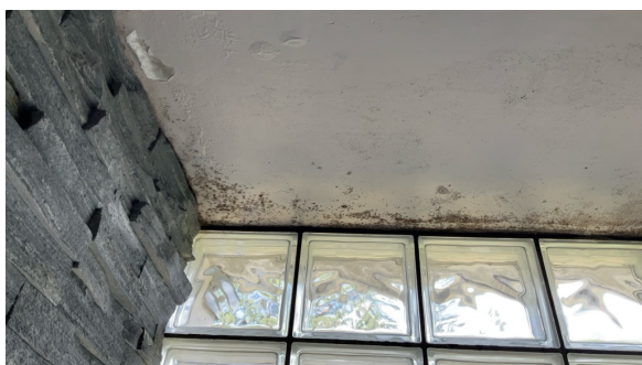
Svartsopp i overgang glassbyggestein og tak.
