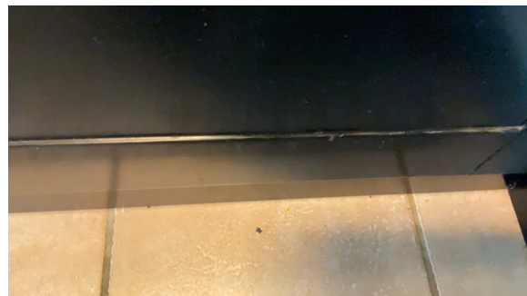
Noe fuktsvelling på front på benkeskap.
