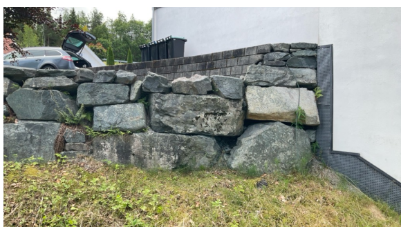
Støttemur uten rekkverk.
