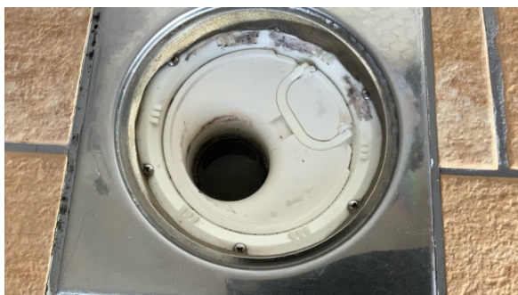
Sluk i dusjsonen
