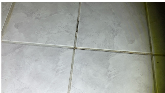
Sprekker i fugemasse i våtsonen
