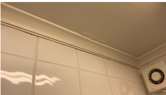
Fuktskade i tak på vaskerom.
