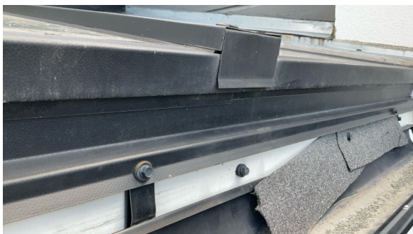
Beslagsløsning ved takrenner er ikke gunstig.
