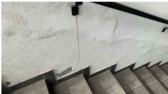
Løs puss i trapperom til underetasjen
