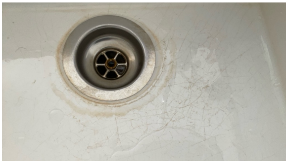
Krakelering i vasken.
