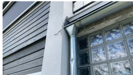
Skade på vegg etter lekkasje i takrenner.
