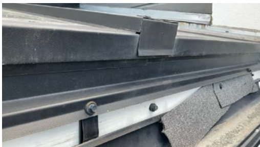
Beslagsløsning ved takrenner er ikke gunstig.
