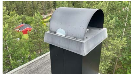
Noe overflatebehandling på pipebeslag mangler.
