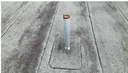
Topphatt på lufting har rustet bort.
