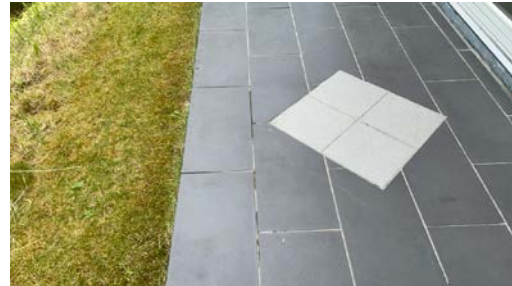
Løse fliser og manglende fugemasse.
