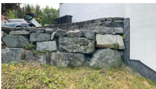
Støttmur uten rekkverk.
