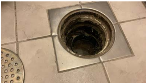
Sluk i vaskerom
