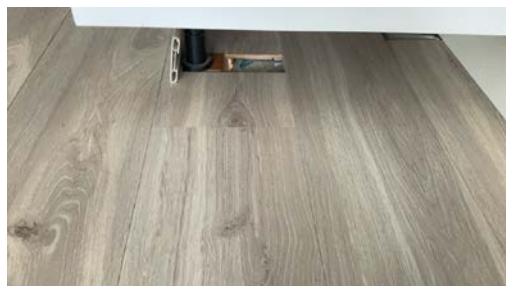
Noe manglende sokkel.
