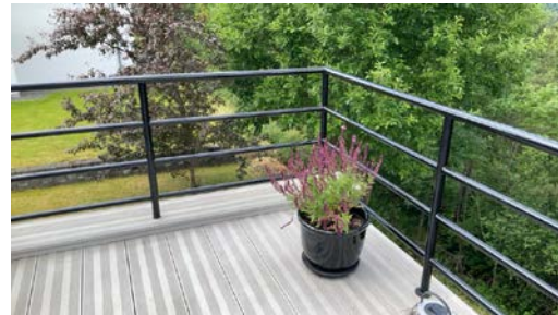
Store åpninger i rekkverk.
