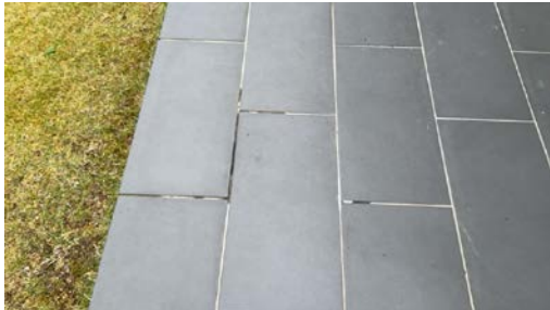
Løse fliser og manglende fugemasse.
