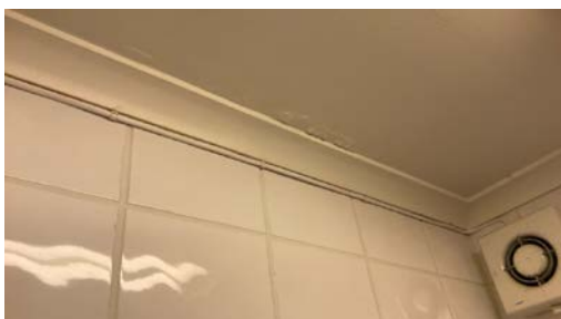
Fuktskade i tak på vaskerom.
