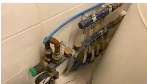
Vannrør kommer ut i rom med sluk.
