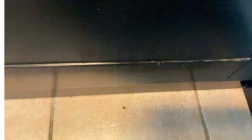
Noe fuktsvelling på front på benkeskap.
