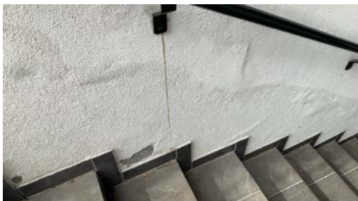
Løs puss i trapperom til underetasjen
