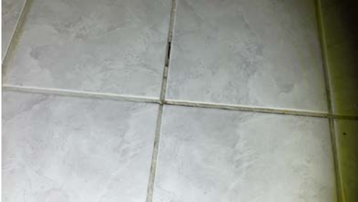
Sprekker i fugemasse i våtsonen
