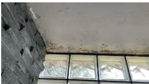
Svartsopp i overgang glassbyggstein og tak.
