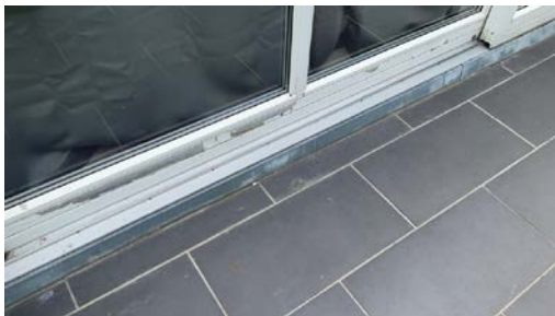
Løs maling på skyvedører i underetasjen
